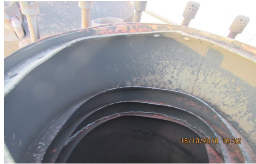
شکل ۸: تخریب تیپ فلر LPG در اثر تنش‌های حرارتی (شرایط عملیاتی)
