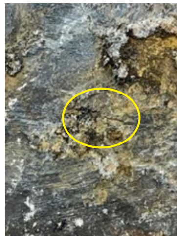
شکل ۷: ترک های مشاهده شده روی سطح لوله
